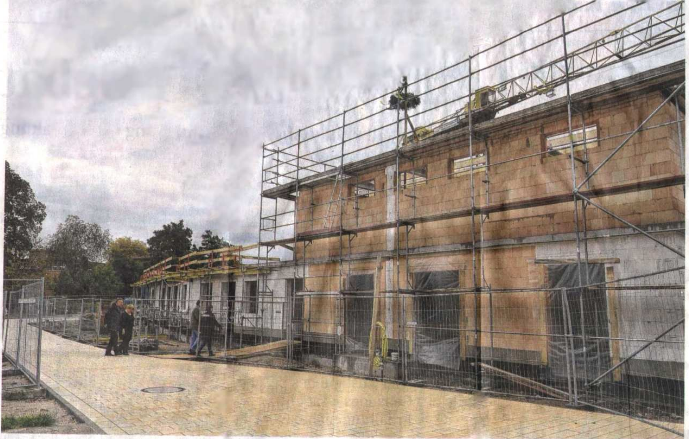
Ein Neubau entsteht auf dem Gelände der Anhaltischen Diakonissenanstalt. Es ist ein Erweiterungsbau für das Anhalt-Hospiz.
